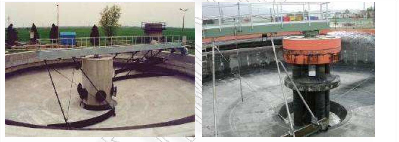
Εικόνα 4.6: Δεξαμενές καθίζησης (Σαρωτές ιλύος)
