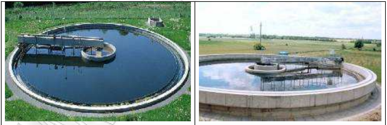
Εικόνα 4.5: Κυκλικές δεξαμενές καθίζησης
