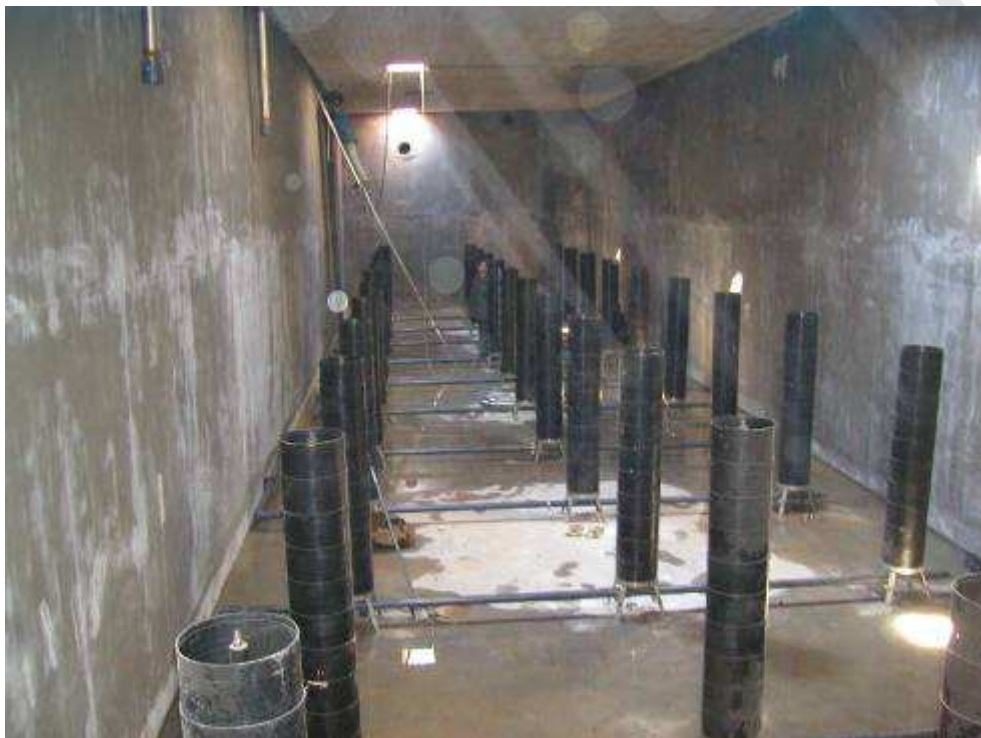
Εικόνα 3.1 : Στατικοί διαχύτες έγχυσης αέρα στις δεξαμενές αερισμού ΦΑΓΕ
