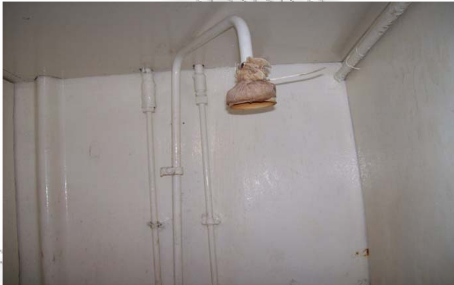
Εικόνα Γ6: Crew's shower in a bad condition
