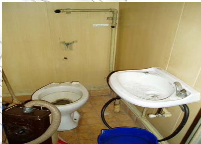
Εικόνες Γ9-Γ10-Γ11: Unacceptable sanitary facilities
