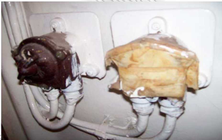
Εικόνα Γ4: The electric equipment is not safe
