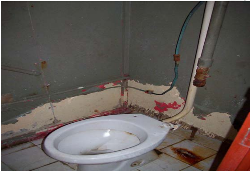
Εικόνα Γ5: Sanitary facilities are unacceptable
