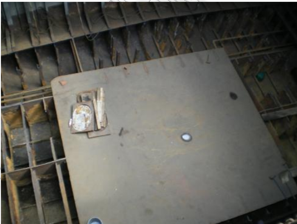
Εκτεταμένες εργασίες στο tank top του κύτους και σε κομμάτι από τις δεξαμενές έρματος (διπύθμενα)
