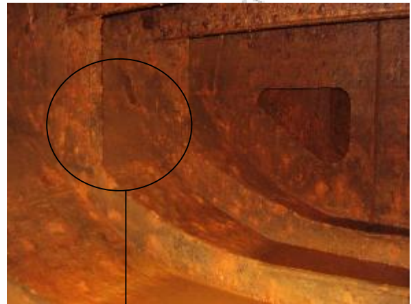
Διάβρωση εδρών των εγκάρσιων νομέων
