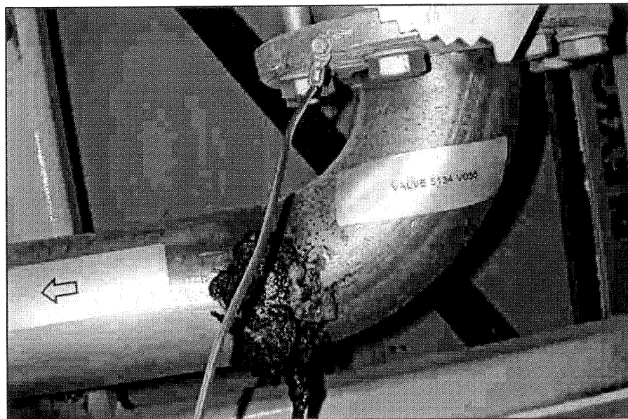
Φαινόμενο HIC σε εξωτερικές σωληνώσεις εγκαταστάσεων
