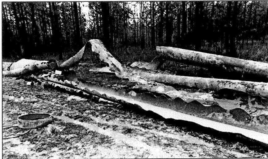
Φαινόμενο SCC) σε εκτεταμένα τμήματα σωληνογραμμών
