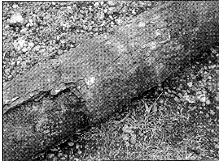
Φαινόμενο Microbiologically Induced Corrosion (MIC) σε τμήμα υπόγειου αγωγού
