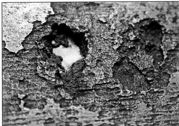
Εκτεταμένη προσβολή οφειλόμενη σε φαινόμενο MIC στο σώμα υπόγειου αγωγού
