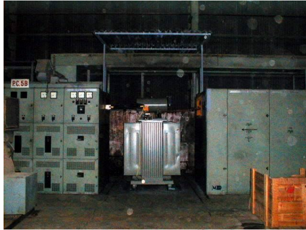
Μετασχηματιστής παροχής υψηλής τάσης
