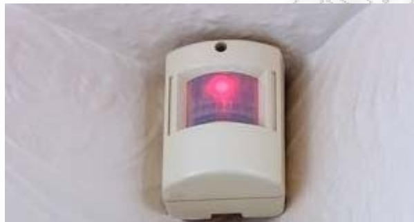
Εικόνα 73. Ανιχνευτής υπέρυθρης ακτινοβολίας τοποθετημένος σε σημείο για την κάλυψη όλου του χώρου.
