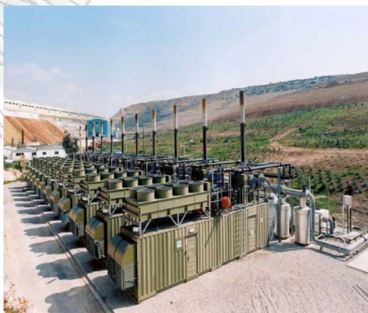
Εικόνα 18: Μονάδα βιοαερίου XYTA Λιοσίων [59]
