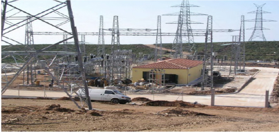
Τυπικός υποσταθμός Υ.Τ. 50.000 ΚVA, 150/21 kV
