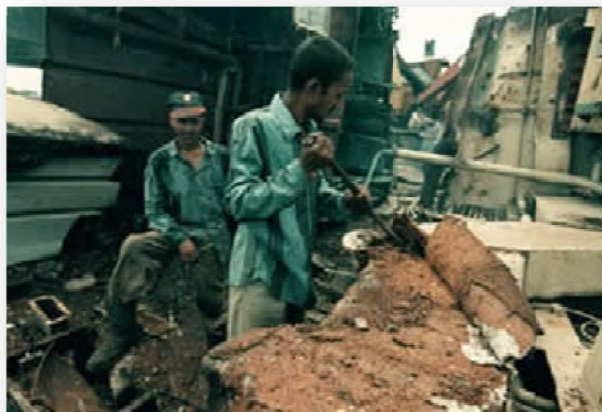
Εικόνα 2.2: Αφαίρεση του αμιάντου χωρίς την κατάλληλη προστασία.
