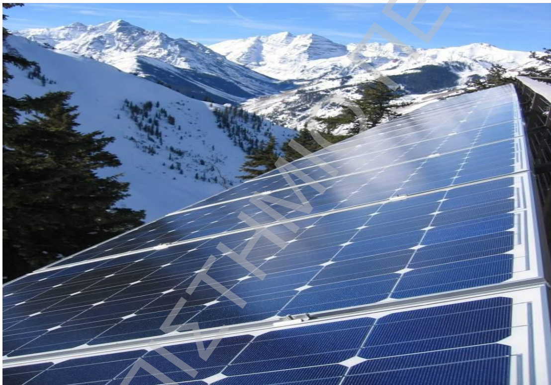
Εικόνα 3.2 Φωτοβολταικά στο χειμερινό θέρετρο Aspen (Πηγή ASC)
