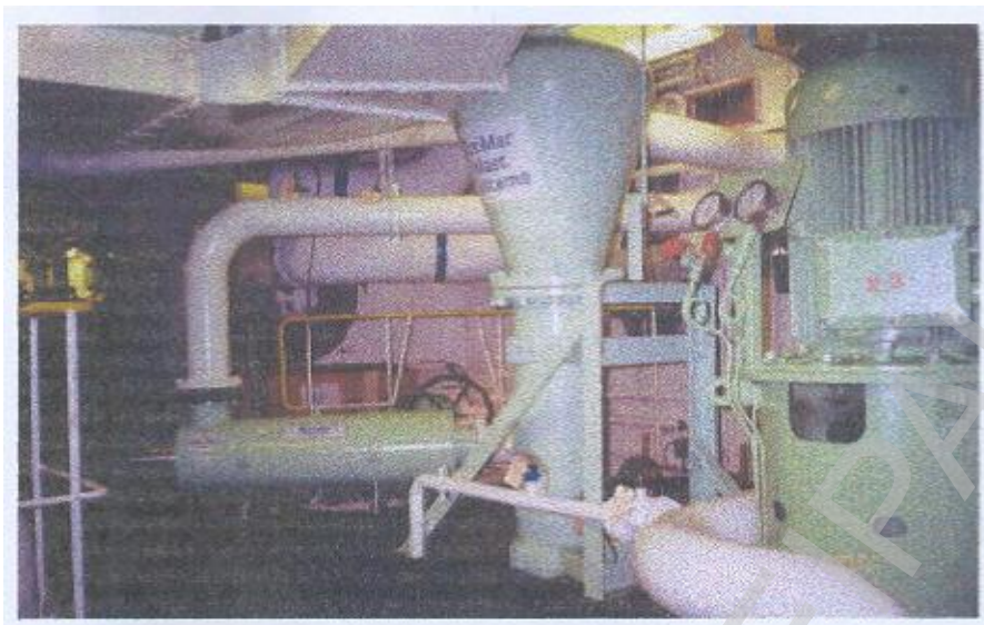
Φωτό 24 : σύστημα έρματος Optimar
