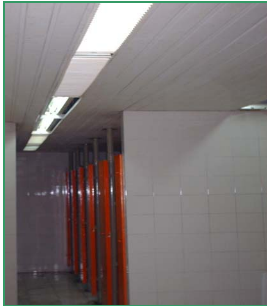
Εικόνα 3-7 Φωτισμός Τουαλετών Κεντρικού Κτιρίου Πα.Πει.
