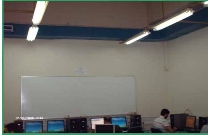
Εικόνα 3-4 Φωτισμός Εργαστηρίων Κεντρικού Κτιρίου Πα.Πει.
