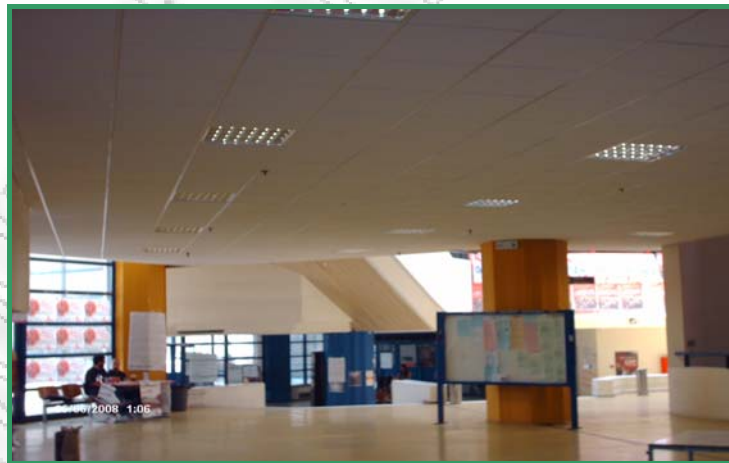
Εικόνα 3-5 Φωτισμός Διαδρόμων Κεντρικού Κτιρίου Πα.Πει.
