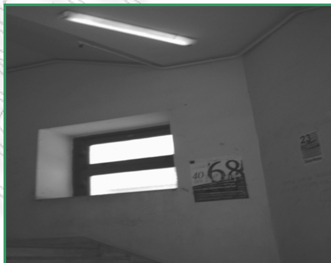
Εικόνα 3-6 Φωτισμός Κλιμάκων Κεντρικού Κτιρίου Πα.Πει.
