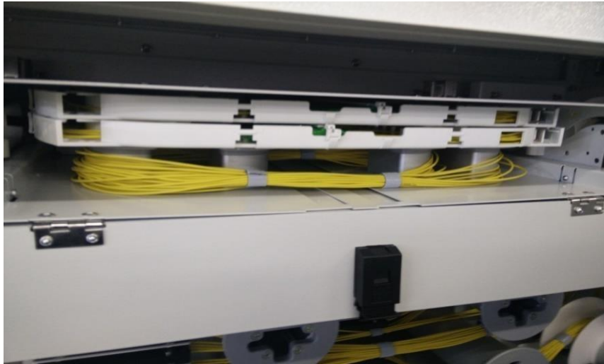
Εικόνα 3.9: Χώρος τερματισμού feeder cable
