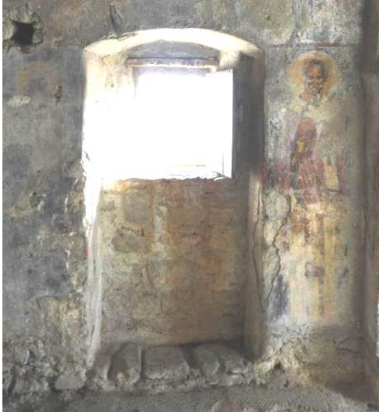
Εικόνα 31: Εμφανής αρμός από παλαιότερο άνοιγμα στην εσωτερική παρειά της τοιχοποιίας του ναού.
