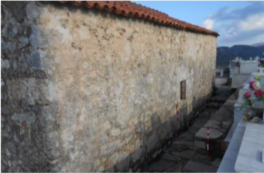
Εικόνα 26: Νότια πλευρά του ναού. Διακρίνεται η υψομετρική διαφορά μεταξύ της δυτικής και της ανατολικής πλευράς, καθώς και το παράθυρο στο μέσον περίπου της όψης.
