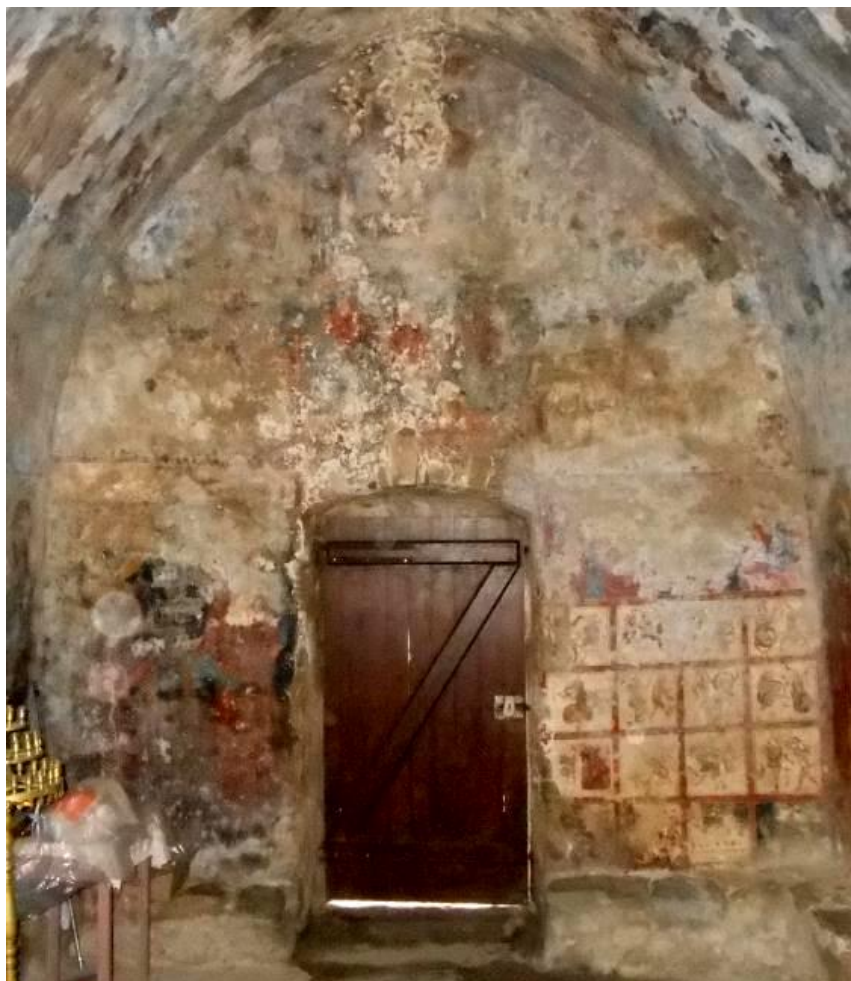
Εικόνα 49: Εσωτερική παρειά δυτικής τοιχοποιίας. Διακρίνεται η έντονη υγρασία που δυσχεραίνει τον εντοπισμό των βλαβών.
