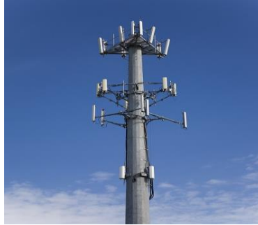
Εικόνα 2: Macrocell πύργος εκπομπής (πηγή: https://www.geo-tel.com/wp-content/uploads/2017/03/CellTowersB.jpg )
