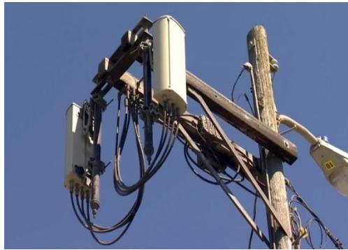
Εικόνα 3: Σταθμός Microcell σε στύλο (πηγή: https://sanfrancisco.cbslocal.com/2015/10/31/san-francisco-residents-battle-wireless-companies-cell-tower-building-boom-super-bowl-fifty/ )
