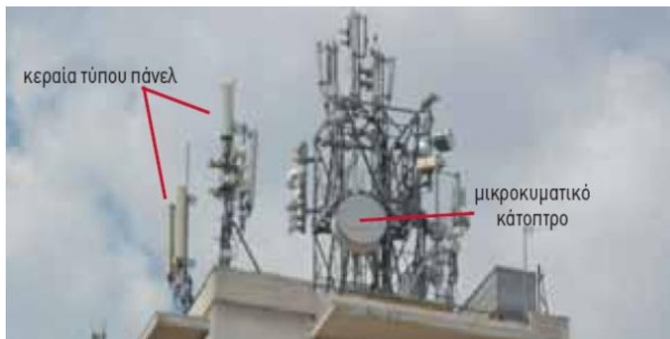
Εικόνα 53: Σταθμός Βάσης Κινητής Τηλεφωνίας
