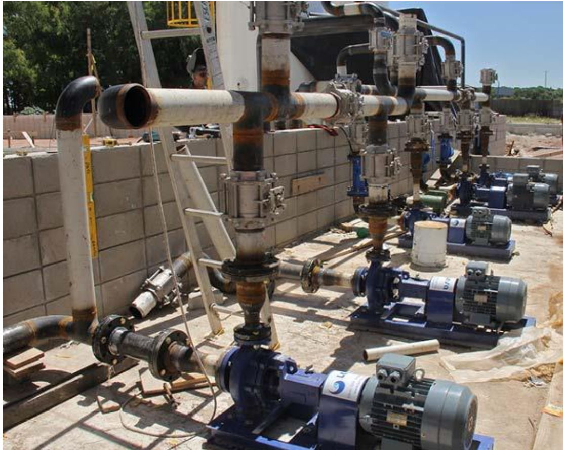
4.2.b. Αντλιοστάσιο φόρτωσης και εκφόρτωσης βυτίων.
