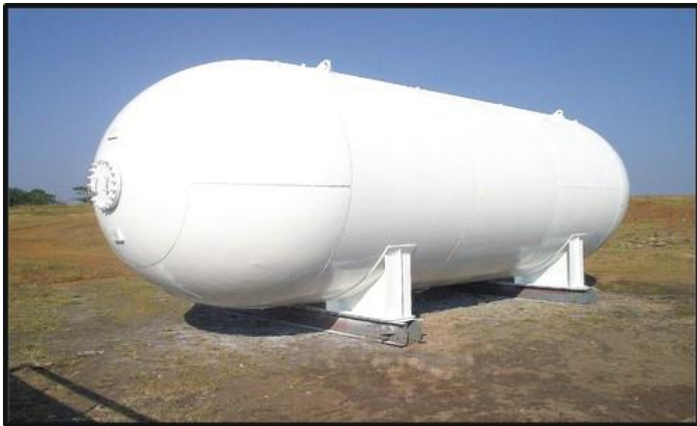
Εικόνα 14: Υπέργεια Δεξαμενή Αποθήκευσης LPG
