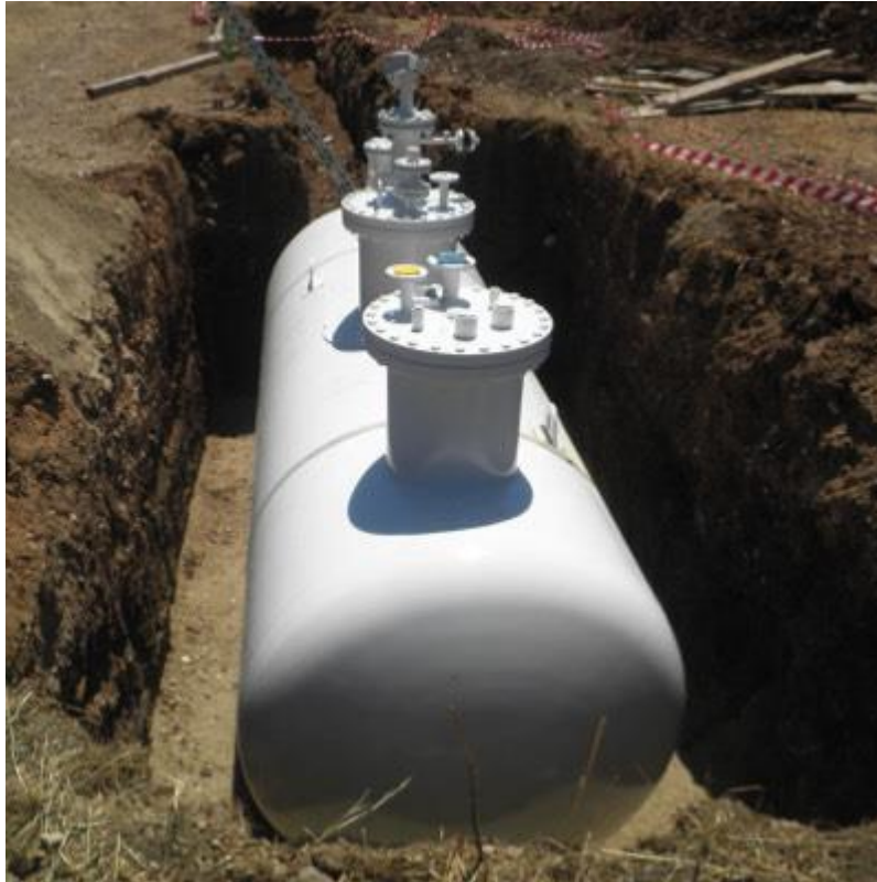
Εικόνα 16: Υπόγεια Δεξαμενή Αποθήκευσης LPG
