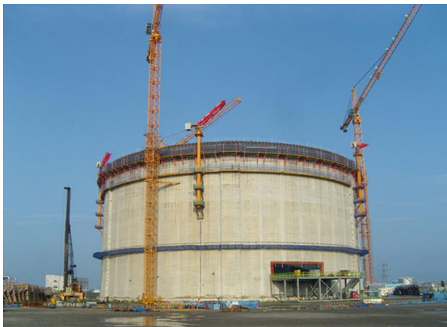
Εικόνα 10: Μεταλλική δεξαμενή διπλού τείχους με ενίσχυση σκυροδέματος
