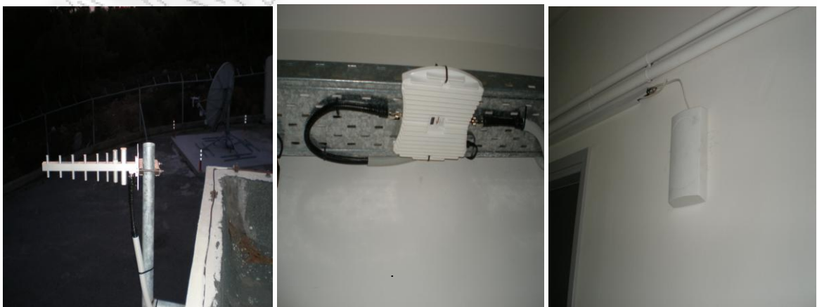
Κατευθυντική κεραία , ενισχυτική διάταξη δικτύου κινητής τηλεφωνίας και κεραία εσωτερικού χώρου για την ασύρματη διασύνδεση του σταθμού EGNOS RIMS Αθηνών (Ελλάδος).
