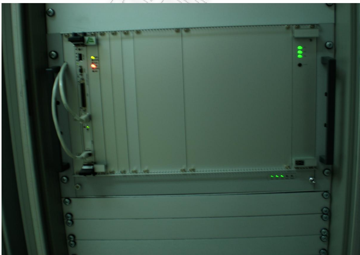
Ο κυρίως Η/Υ του καναλιού RIMS B εγκατεστημένος στο αντίστοιχο κριώμα και ενδεικτικά των βοηθητικών συστημάτων του κριώματος (θερμοκρασίας, ανεμιστήρων, και τάσεων τροφοδοσίας)
