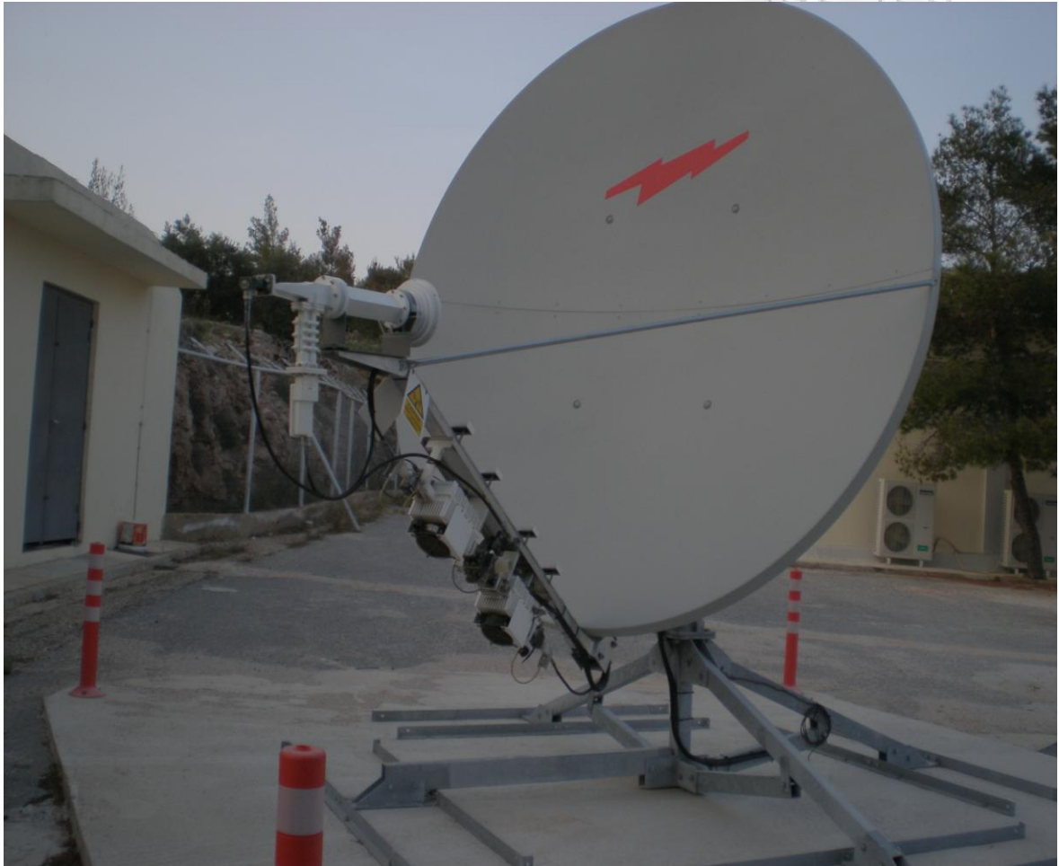
Παραβολική κεραία 2,4 μέτρων για διασύνδεση του σταθμού RIMS της Ελλάδος με τον γεωστατικό δορυφόρο « ARTEMIS » .
