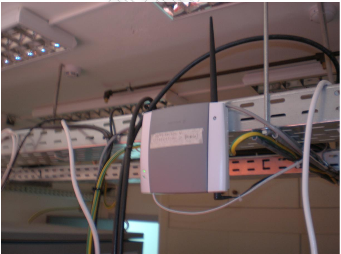
Ασύρματες ζεύξεις με δίκτυα κινητής τηλεφωνίας, εξασφαλίζουν τις τηλεπικοινωνιακές διασυνδέσεις (φωνής και δεδομένων) του σταθμού με τα 4 κέντρα ελέγχου και τις λοιπές υπηρεσίες της ESA.
