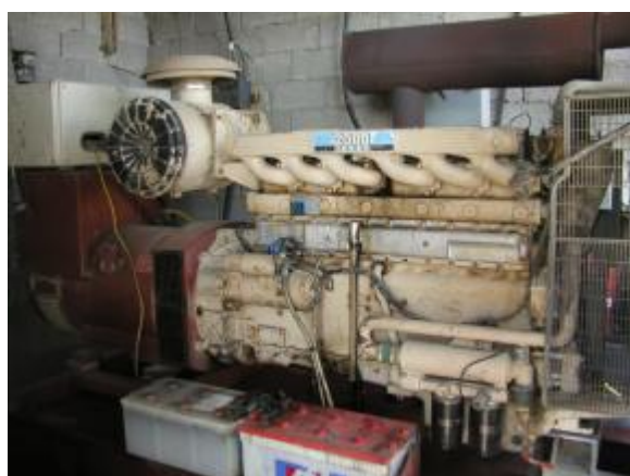
Εικόνα 6: Γεννήτρια τύπου Perkins
