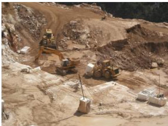
Εικόνα 21: Άποψη ενεργειακής διάταξης λατομείου
