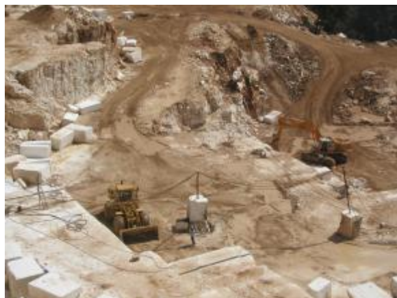
Εικόνα 22: Άποψη ενεργειακής διάταξης λατομείου
