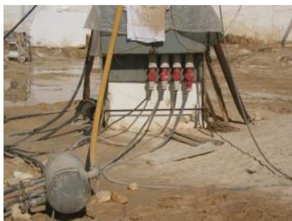
Εικόνα 24: Άποψη ενεργειακής διάταξης λατομείου
