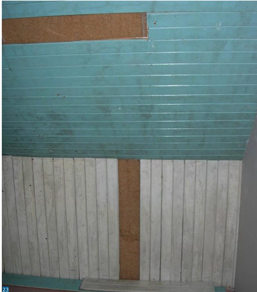
Εικόνα 23: Ξύλινη ινοσανίδα που χρησιμοποιείται πίσω από μια υπάρχουσα ξύλινη επένδυση σε ένα κομμωτήριο.
