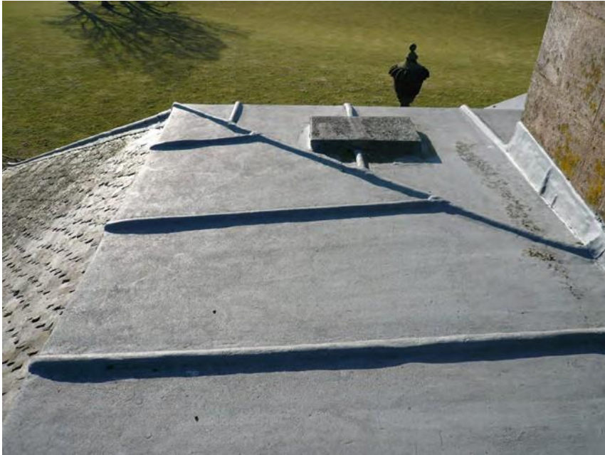
Εικόνα 25: Απαιτείται προσοχή όταν μια επίπεδη οροφή καλύπτεται με μόλυβδο ή άλλο μέταλλο για να μην προκληθούν συνθήκες στην κάτω πλευρά που οδηγούν σε διάβρωση μετά την μετασκευή.
