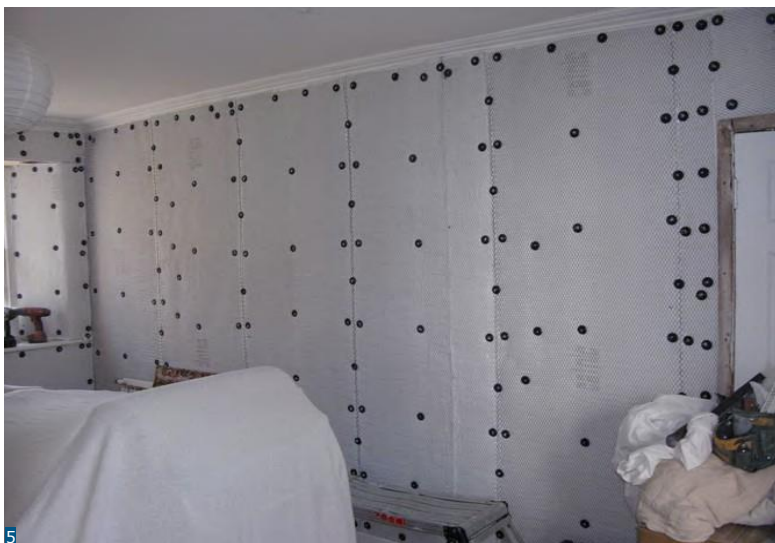
Εικόνα 55: κουβέρτα αερογέλης που εφαρμόζεται απευθείας στην τοιχοποιία χρησιμοποιώντας θερμικά αποσυνδεδεμένους συνδετήρες διαστολής (Θήκη ανακαίνισης Μελέτη 3).
