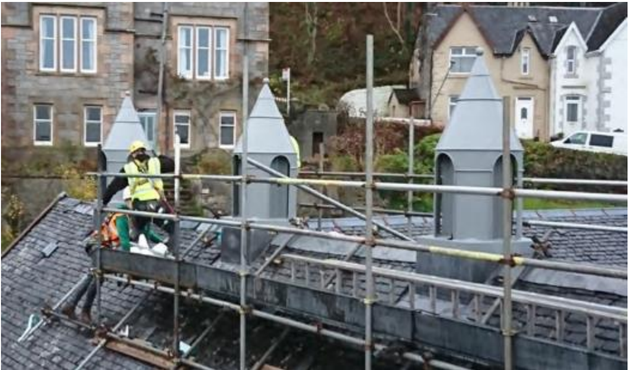
Εικόνα 5.3.1: Αποκαταστάθηκαν οι αεραγωγοί στο επίπεδο της κορυφογραμμής σε ένα πρώην σχολείο στο Oban. Εικόνα © RockfieldCenter
