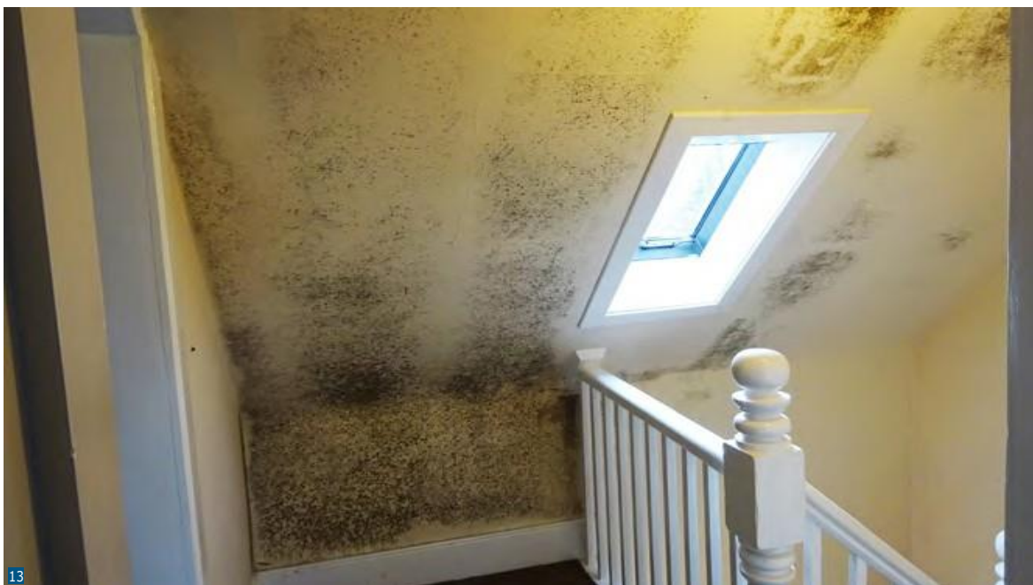
Εικόνα 13: Αδιαπέραστα από τους ατμούς υλικά και έλλειψη αερισμούέχουν οδηγήσει σε σημαντική ανάπτυξη μούχλας στις εσωτερικές επιφάνειες αυτού του κτιρίου.
