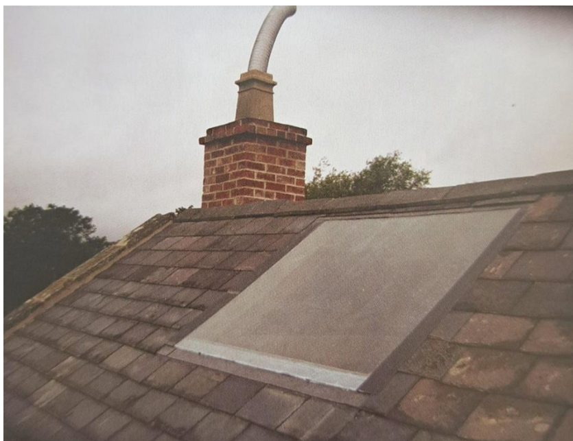
ΕΙΚΟΝΑ 4.2.1: Ηλιακό πάνελ τοποθετημένο κατά πάνω από ένα ψευτικό τζάμι, προκειμένου να αποκτηθεί η άδεια χρήσης σε μια διατηρητέα περιοχή.
