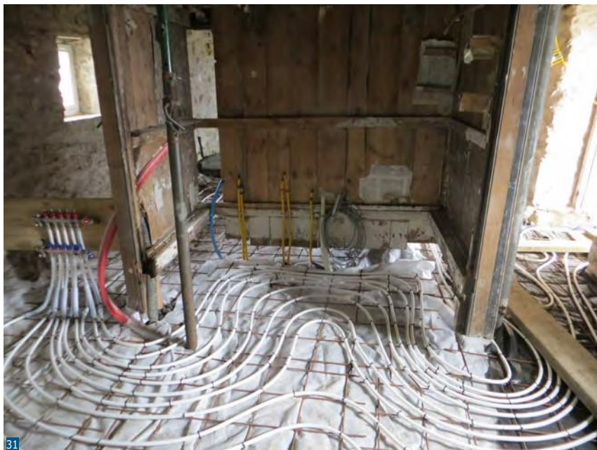
Εικόνα 31: Πηνία για ένα δάπεδοσύστημα θέρμανσης που τοποθετείται πάνω από ένα δάπεδο ασβεστοκονιάματος. Η θέρμανση τροφοδοτείται από αντλία θερμότητας εδάφους. Εικόνα © CallumIn
