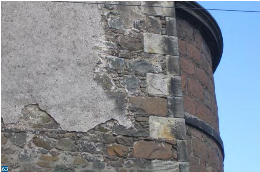
Εικόνα 63: Αυτό το άκρο αέτωμα, το οποίο χρειάζεται συντήρηση και δείχνει τα υπολείμματα ενός ασβεστόλιθου, είναι καλά τοποθετημένο για να δέχεται μια κατάλληλη μορφή λεπτής εξωτερικής μόνωσης.
