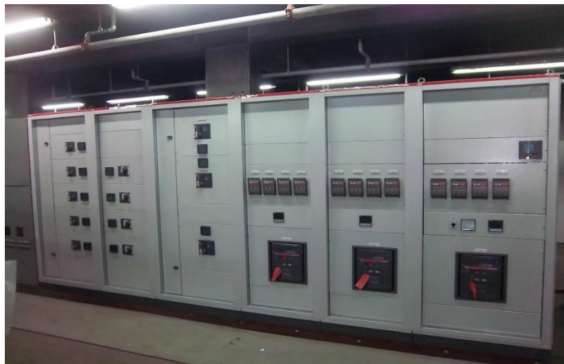
Εικόνα: Πίνακας Χαμηλής Τάσης
