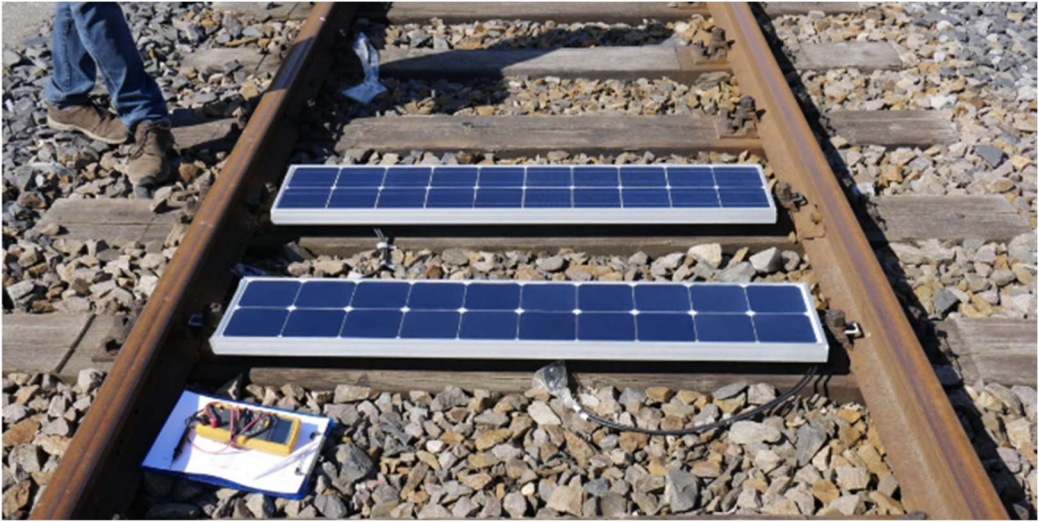
Εικόνα 29. Φωτοβολταϊκά για σιδηροδρομικές γραμμές 43
