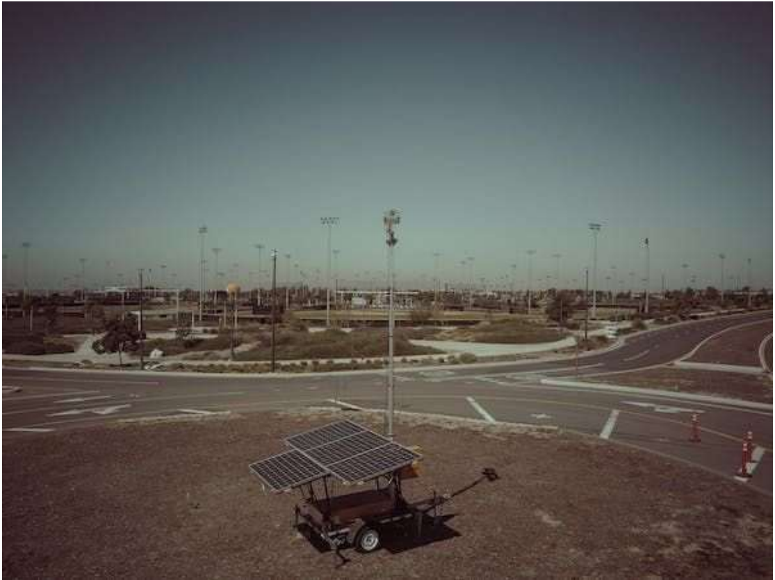
Εικόνα 58. Φωτοβολταϊκά σε δίοδια και τούνελ
