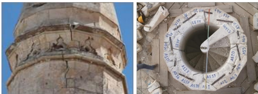
Εικόνα 6.1.12 Ήδη από τα μέσα του 1990 η κατάσταση του μιναρέ τον καθιστούσε επικίνδυνο
