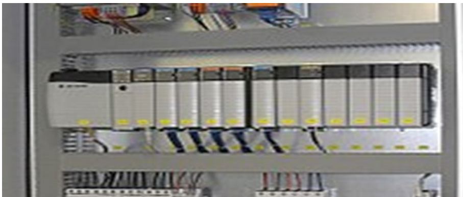
Σχήμα 10. Το PLC Allen-Bradley είναι εγκατεστημένο σε έναν πίνακα ελέγχου
