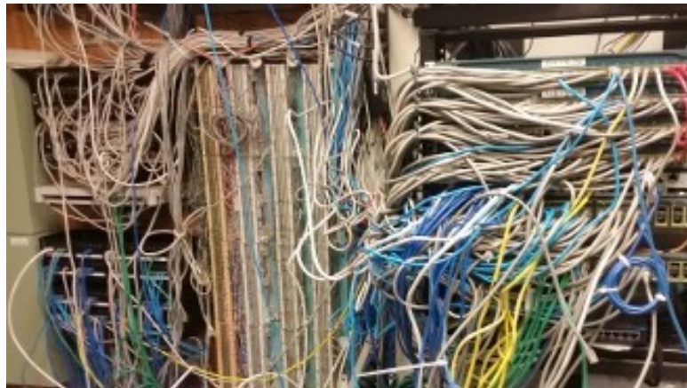
Εικόνα 56: Οι ηλεκτρολογικοί πίνακες είναι ένα κλασικό παράδειγμα εξοπλισμού με χαμηλό βαθμό συντηρησιμότητας.
