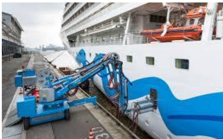
Figure 23: Σταθμός Ηλεκτρικής Παροχής σε κρουαζιερόπλοιο της εταιρίας AIDA στο Cruise Centre Altona (Αμβούργο)
